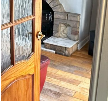
Pic38: loose door handles
